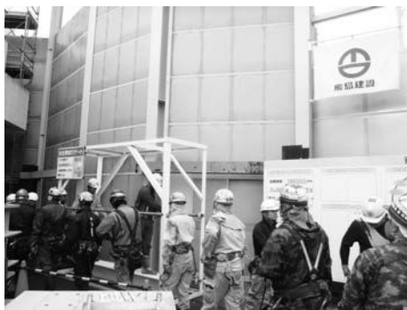
写真－2 安全帯試行ゲート
